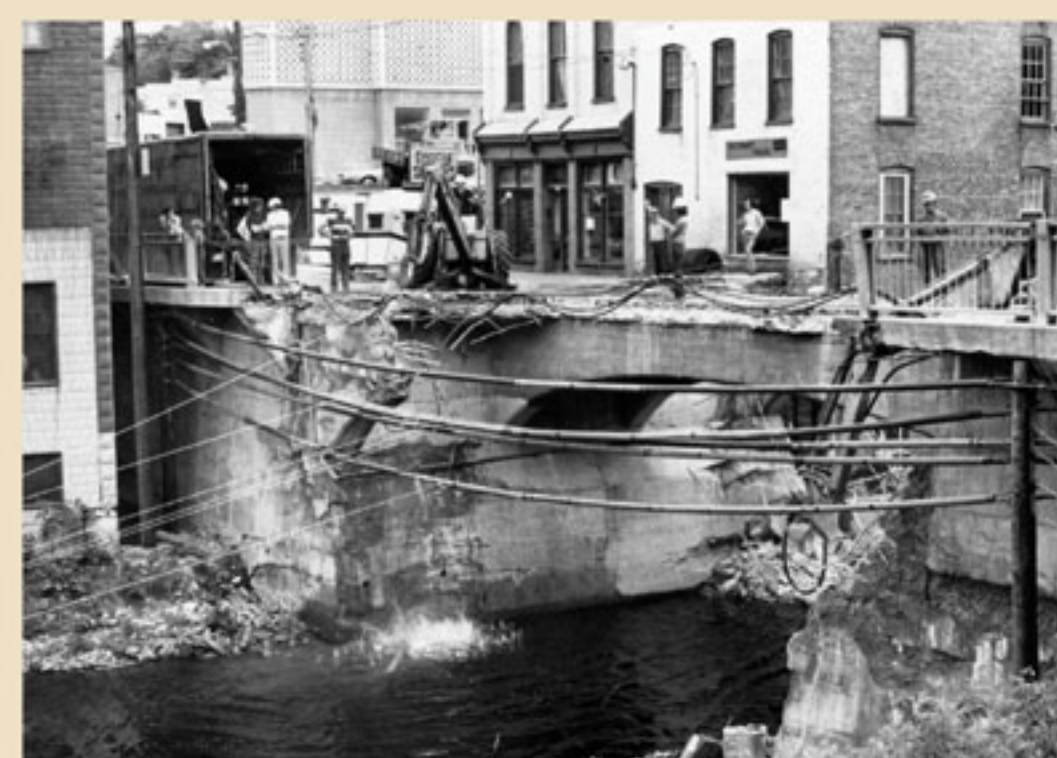
En 1975, les édifices de droite, adjacents au pont de la rue Principale, disparaissent à la suite d'un incendie ; quant à la Giddings, à gauche, elle sera bientôt démolie pour permettre l'élargissement du pont.
